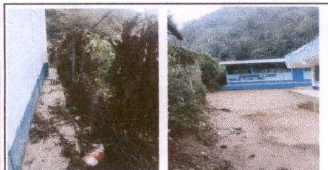
Foto 5: Reparación de muro perimetral de block. Reparación de tubo hg y malla galvanizada
